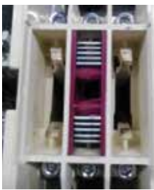
Kontaklar ve Ark Söndürme Hücreleri
